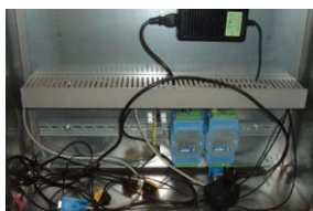
Fig. 2-2 Expert遠隔I/Oモジュールと配線
