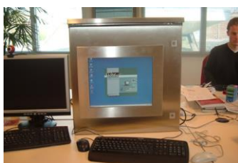
Fig 2-4 制御盤に設置したタッチパネル (遠隔I/Oモジュール、組込みボード、電源は盤内に設置)
