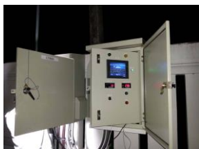
Fig. 1-2 遠隔I/Oモジュールと産業用パネルPC、 電源スイッチ、UPS、配線
