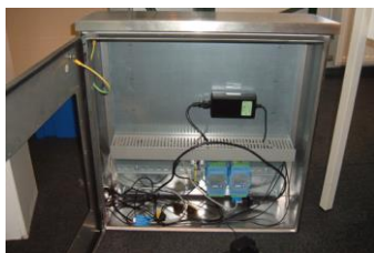
Fig. 2-1 遠隔I/Oモジュール、組込みボード、電源を制御盤内で一体化 ※スクリーンは扉に設置しています。 ※組込みボードは奥に設置しています。
